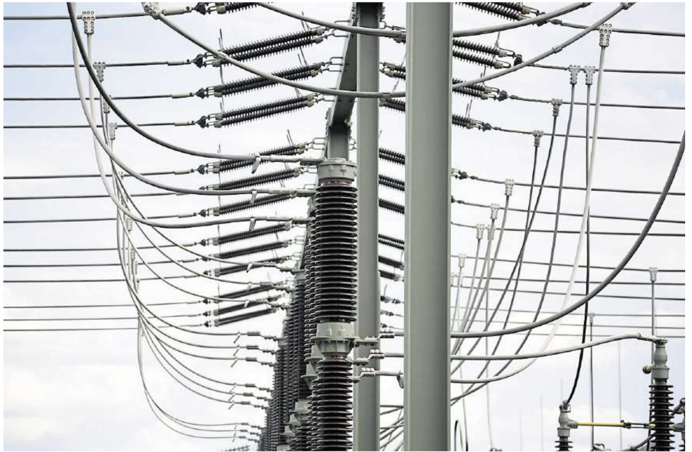
Kritische Infrastrukturen haben oft verletzliche Knotenpunkte wie hier beim Entega-Umspannwerk in der Waldkolonie. Foto: Guido Schiek
